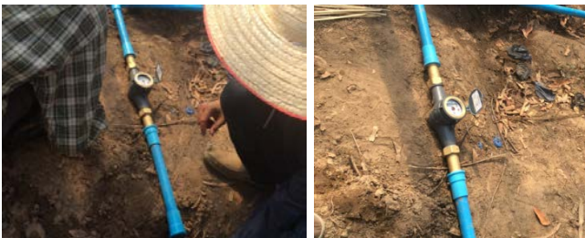
ภาพที่ 12 การติดตั้งมิเตอร์วัดอัตราการไหล
